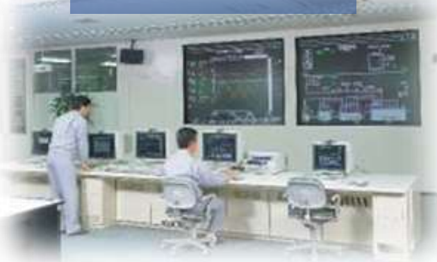
集中監視制御装置
