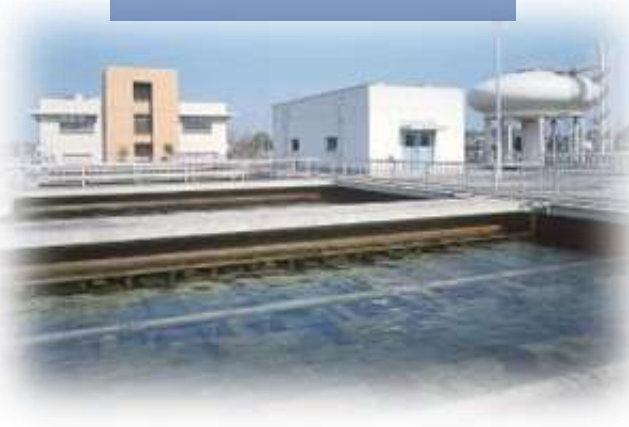
上水処理施設
