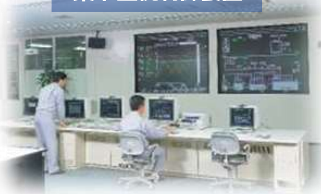
集中監視制御装置
