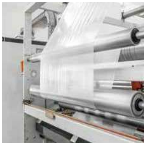
フィルム製造・加工設備制御システム
