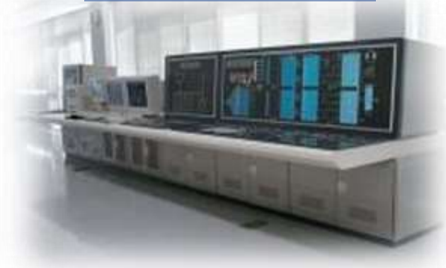
集中監視制御装置
