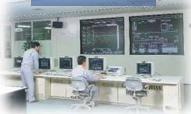
集中監視制御装置
