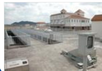
上下水道用 電気計装システム
