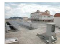
上下水道用 電気計装システム
