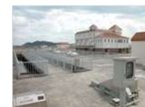
上下水道用 電気計装システム
