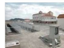
上下水道用 電気計装システム
