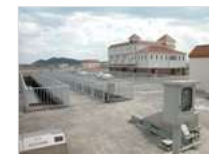
上下水道用 電気計装システム
