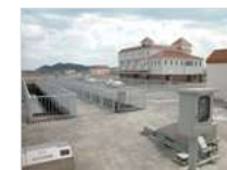
上下水道用 電気計装システム
