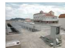
上下水道用 電気計装システム
