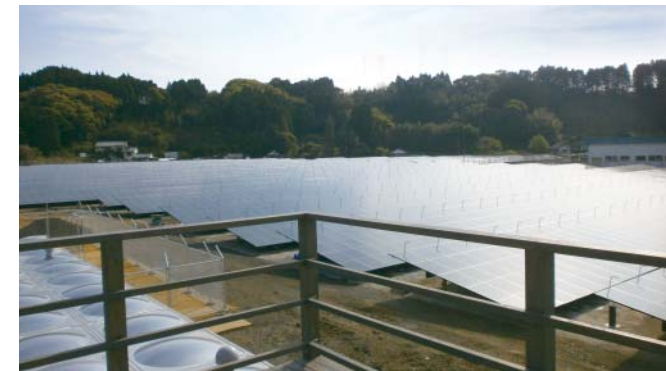
西都発電所(発電規模: 1.8MW)
