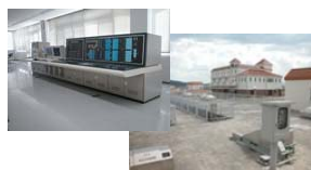
上下水道用電機システム
