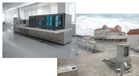
上下水道用電機システム
