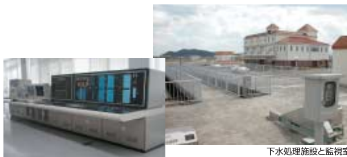
下水処理施設と監視室
