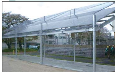
太陽光パネル 運動場設置のため、パネル面に防護ネットを取付けています。
