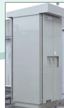
屋上に設置された風力パワーコンディショナ*2
