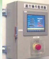
職員事務所に 設置された 遠方操作監視盤
