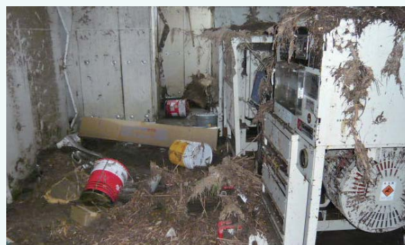
津波により水没した電気室
