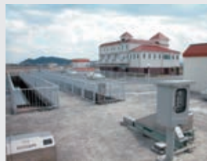
上下水道用電気計装システム
