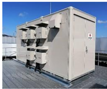
安川テクノロジーセンタ 蓄電池
