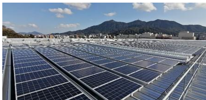
安川テクノロジーセンタ 太陽光発電
